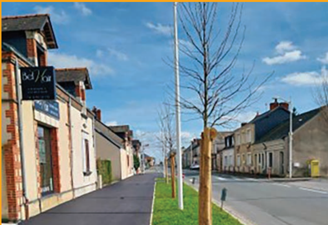
Réfection des trottoirs et pose de bordures. Rue de Bretagne à Combrée
