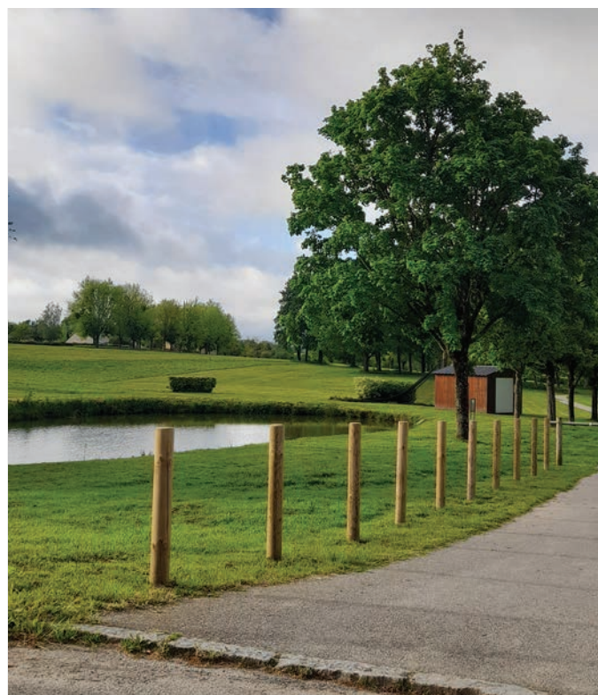
Pose de potelets au plan d'eau de Combrée en remplacement de la haie, dégageant la vue sur le swin-golf
