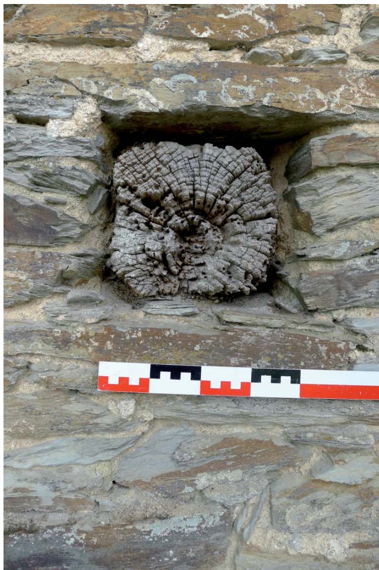
Fig. 29 : Vue de détail d'une des pièces de chêne scellée dans le mortier de pose et probablement liée à des dispositifs de levage de charges lourdes (UE 1002).
